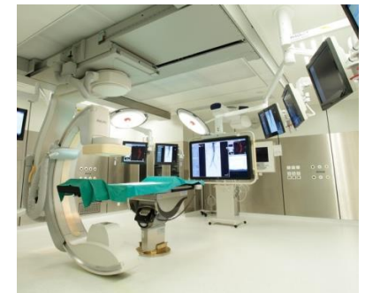
手術室等の設計施工
