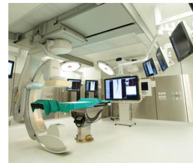
手術室等の設計施工
